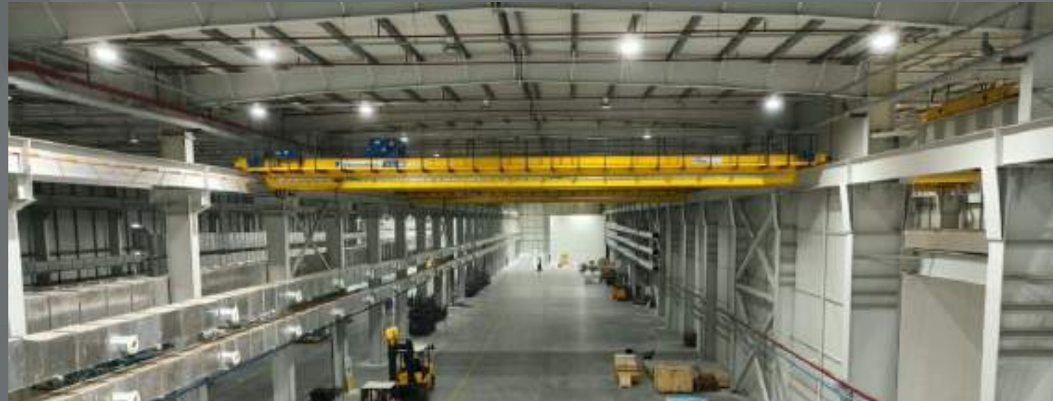
100 MT EOT CRANE
