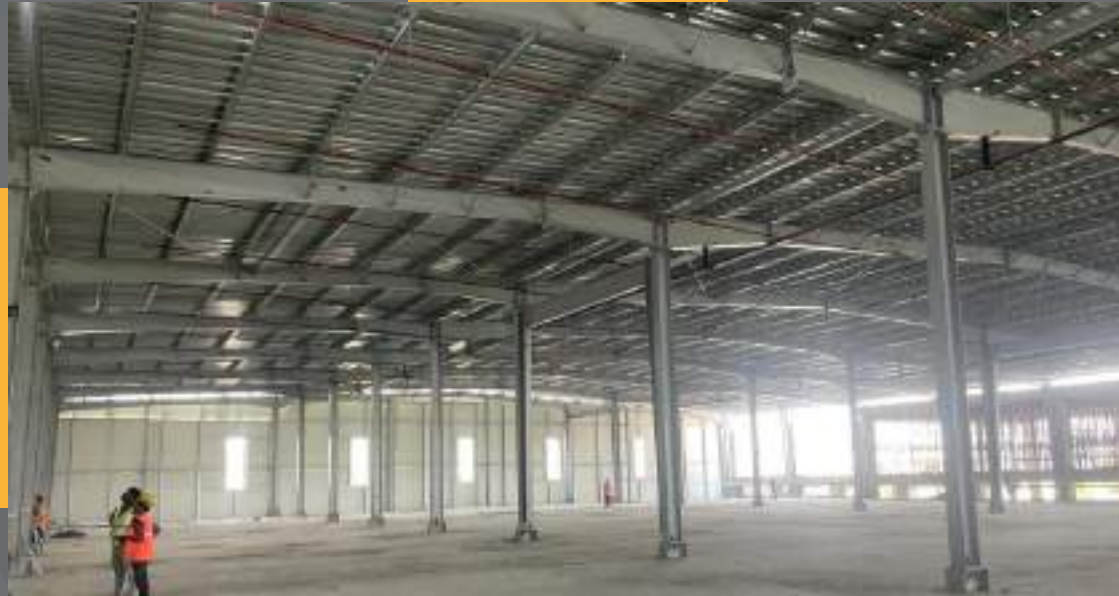
First Floor Production : 25 M * 8 Grid : Floor Load : 1.75 MT / Sqm ( Point Load ) Height : 6 M +
